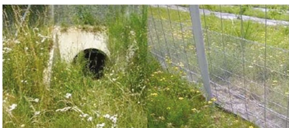
Exemple de buse avec clôture spécifique (Source SNCF Réseau)
