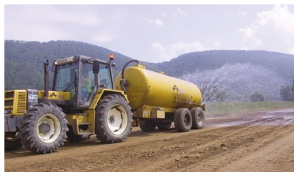
Arrosage des pistes (Source SNCF Réseau)
