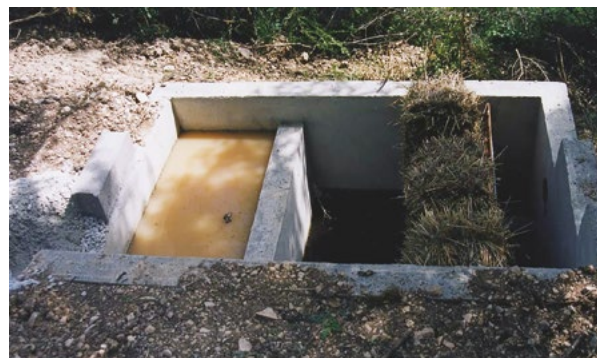
Filtre à paille (Source Egis)
